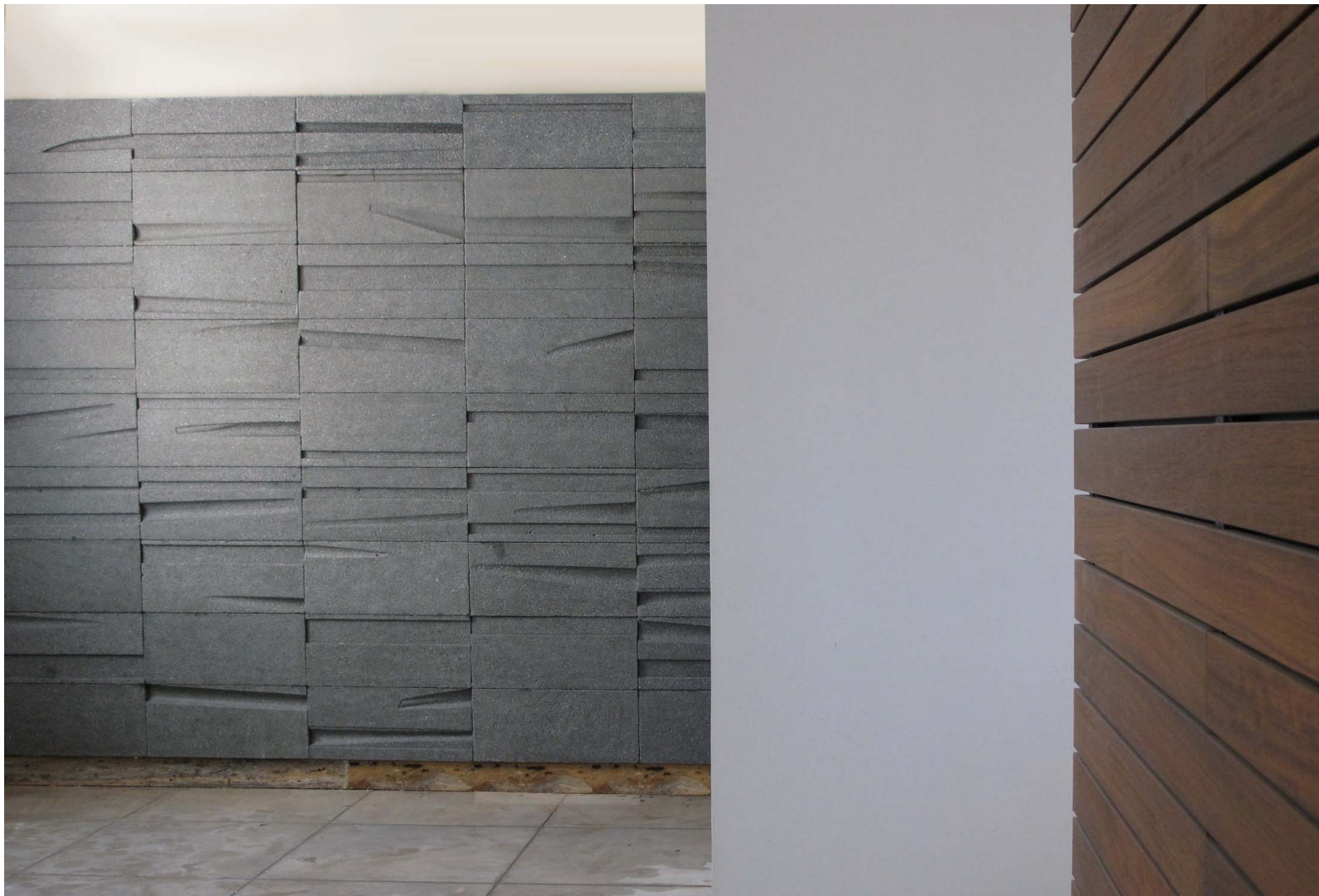
بدون عنوان، قطعات بتن (دیتیل)، ۲۴۰ X ۳۵۰ سانتی متر، دفتر شرکت پایون آریا، ۱۳۹۳، تهران.
